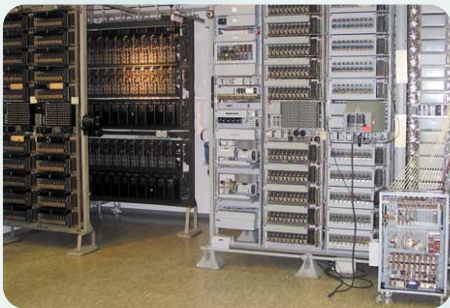
Ortsvermittlung in Mischbauweise
