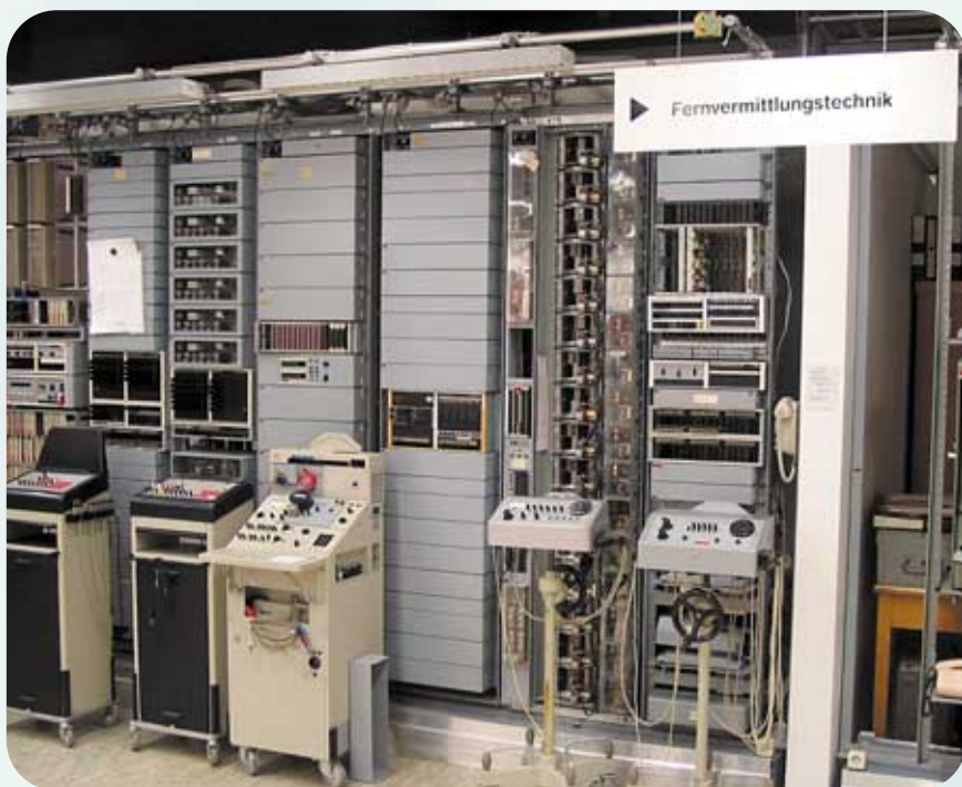
Knotenvermittlung System T 62
